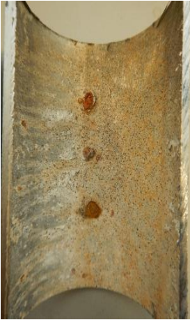
Obr. 1 Časť potrubia na prípravu metalografického výbrusu
